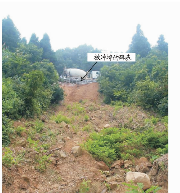
图 8 山洪冲垮路基
